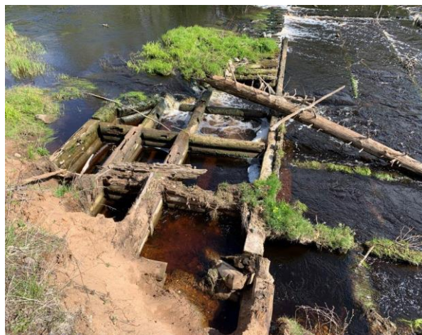
Рисунок 3.5.2. Разрушенный шлюз, р. Соминка - д. Лопастино
