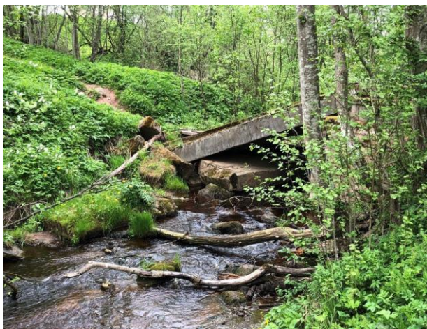
Рисунок 3.5.1. Разрушенный бетонный мост, р. Ящера- д. Пехенец
